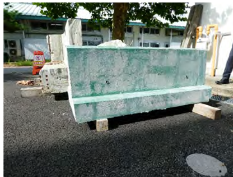
(B) 塩害の地覆（越前海岸にかかっていた橋）
