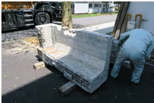
(A) 井上橋の外桁と端横桁（鉄筋露出）
