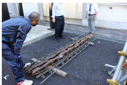
(C) 天神橋の伸縮装置 (今後、半分を補修する予定)
