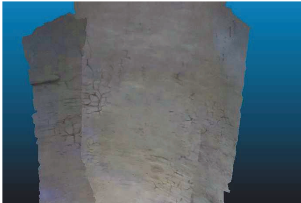
(c) アーチ天井のモルタルひび割れ
