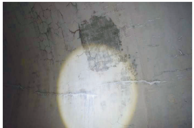
写真 11 仕上げモルタルのひび割れ
