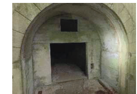
写真4 トンネル開口 付壁(坑門から約2m)
