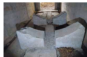
写真8 タンク架台と 思われるコンクリート
