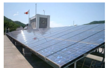
舞鶴高専屋上に設置した 50kW 太陽光発電システム
